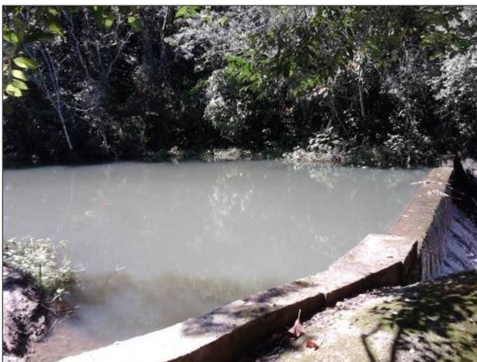
Figura 32 Rio 1 Praia da Lagoa. Represamento de água na captação da CASAN. Fonte: Autor.
