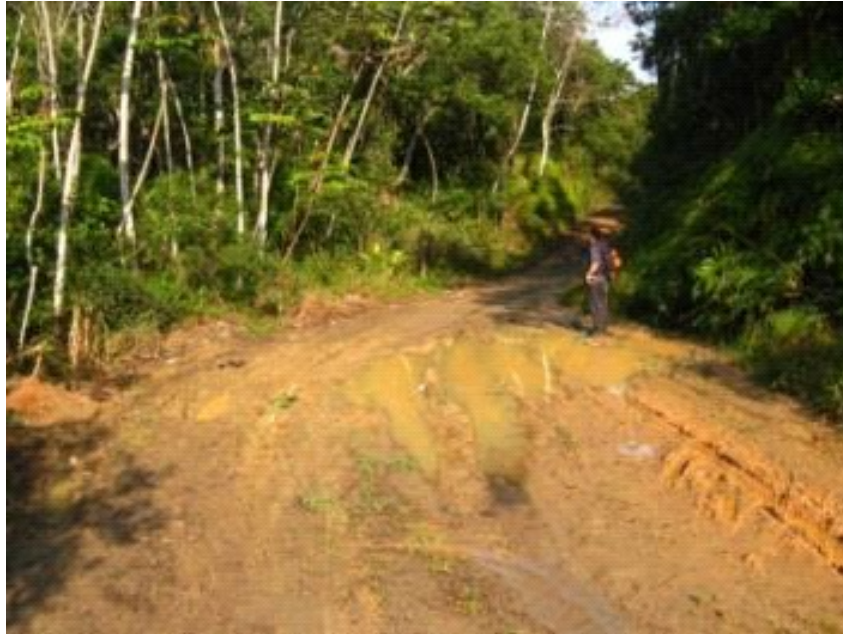
Figura 1.62: Problemas de drenagem, trilha do Divisor (trecho da estrada das antenas).
