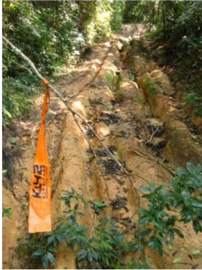
Figura 1.72: Evidência de processos erosivos e marcação abandonada da prova de corrida de aventura K42.
