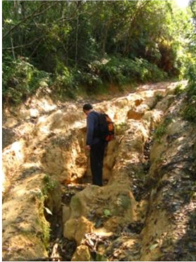
Figura 1.73: Evidência de processos erosivos acentuados pelo uso com motocicletas e jipes, trilha do Divisor.
