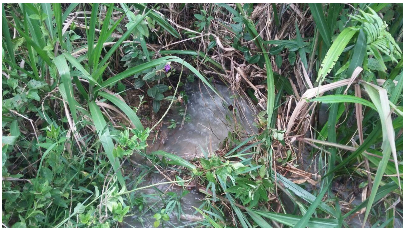
Figura 01: Identificação de rompimento na adutora
