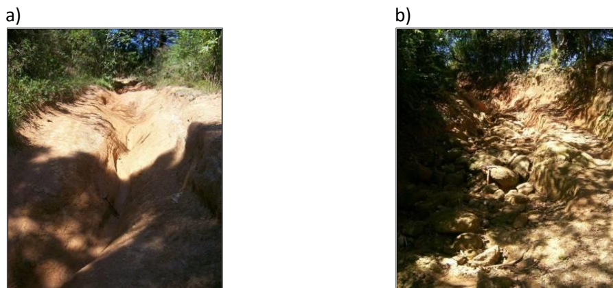
Figura 10: Vala formada por erosão pluvial, de quase 1 m de profundidade (a) e erosão do solo acompanhado por deslizamento de blocos (b)
