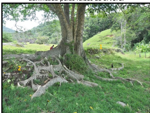
Figura 279. Detalhe das fundações 1 e 2; a segunda foi danificada pelas raízes da árvore.
