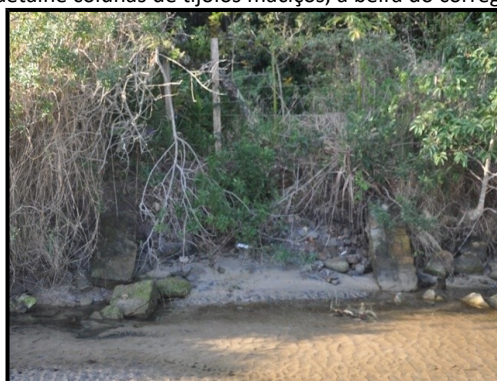
Figura 276 - Vista das ruínas da antiga edificação, em detalhe colunas de tijolos maciços, à beira do córrego.
