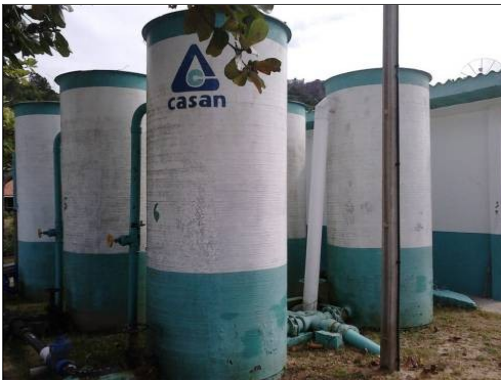
Figura 15 Estação de Tratamento de Água, ETA Zimbros-CASAN. Fonte: Autor.
