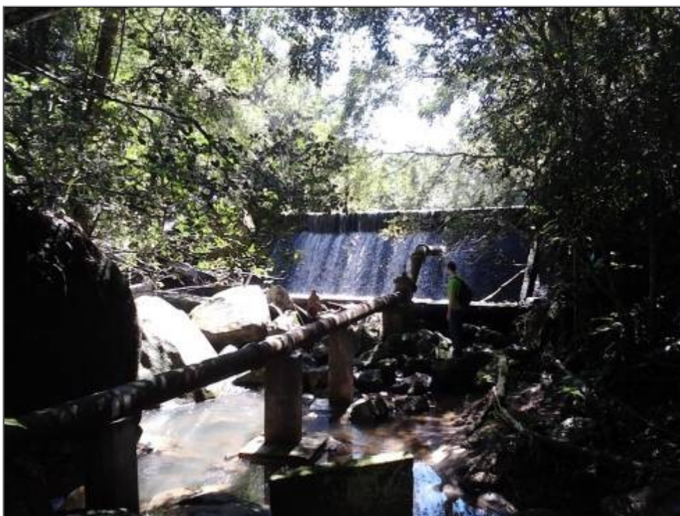
Figura 31 Rio 1 Praia da Lagoa. Barragem e canalização para captação de água da CASAN. Fonte: Autor.
