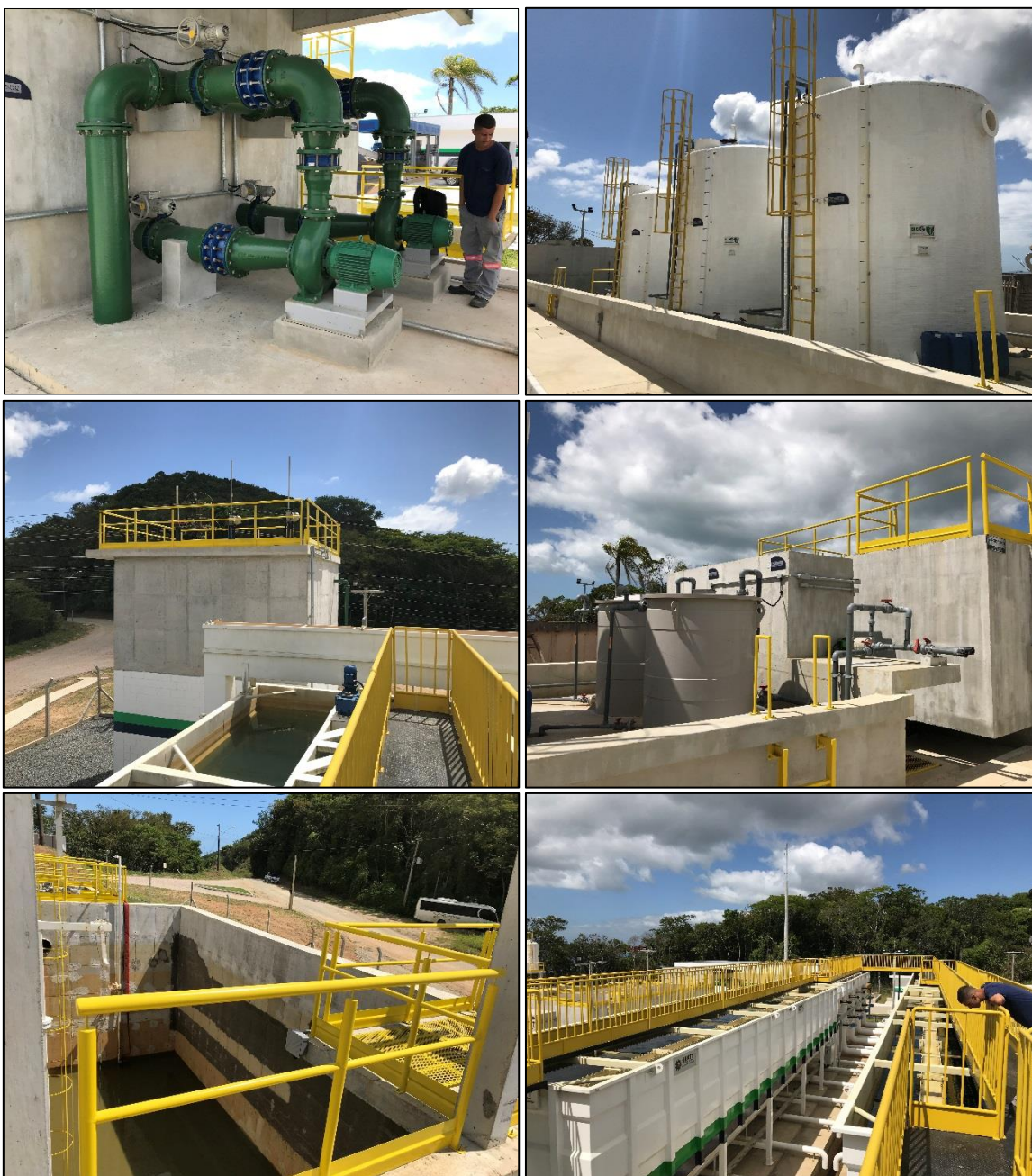
Figura 71 – Estação de Tratamento de Água – ETA BOMBINHAS.
