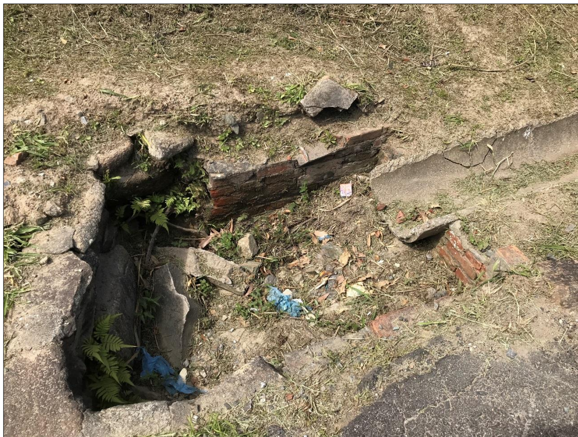
Figura 92 – Sistema de Drenagem com obstrução por resíduos sólidos.
