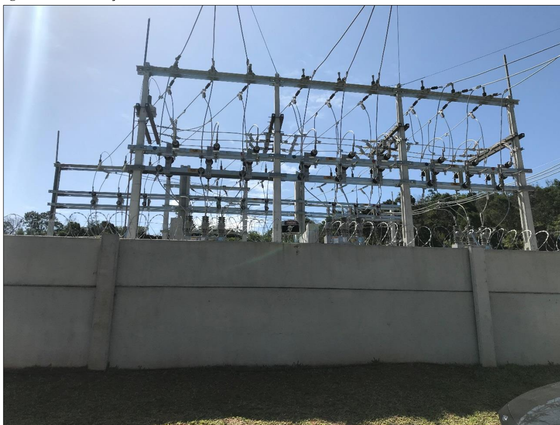
Figura 93 – Subestação de Bombinhas.
