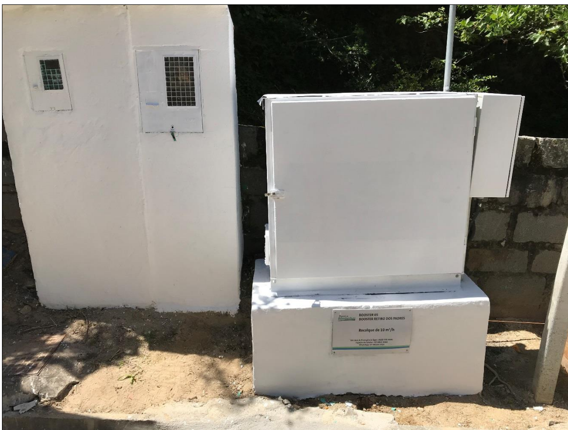
Figura 78 – Estações elevatórias de esgoto.
