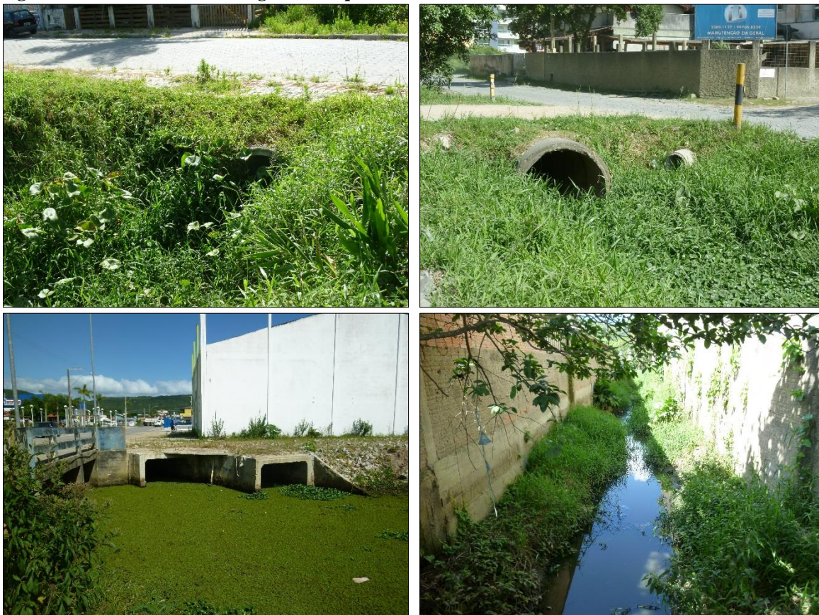
Figura 170– Estrutura de drenagem inadequada.
