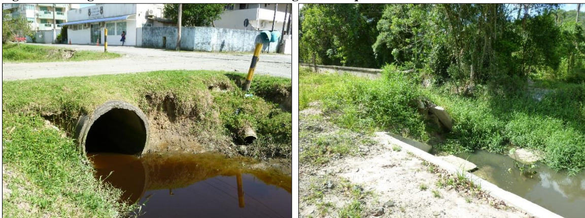
Figura 173– Esgoto sanitário acumulado em drenagem inadequada
