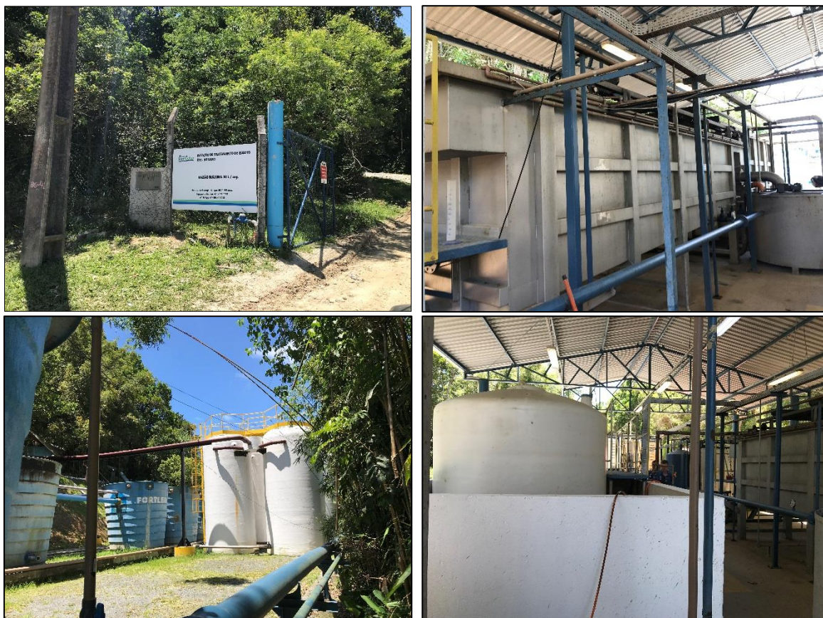
Figura 77 – Estação de Tratamento de Esgoto – ETE BOMBAS.
