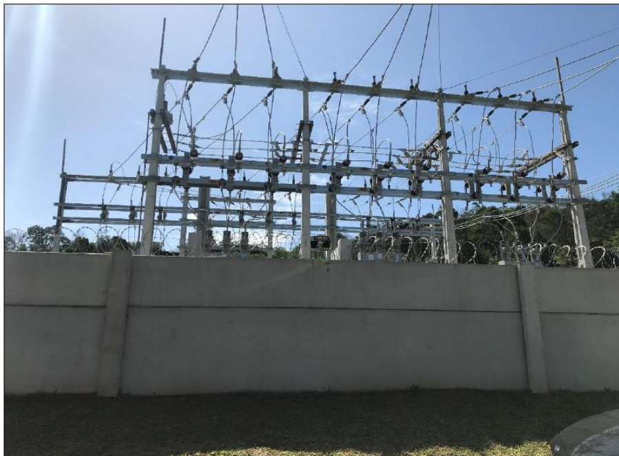
Subestação de Bombinhas (Alto Uruguai Engenharia e Planejamento de Cidades, 2018).
