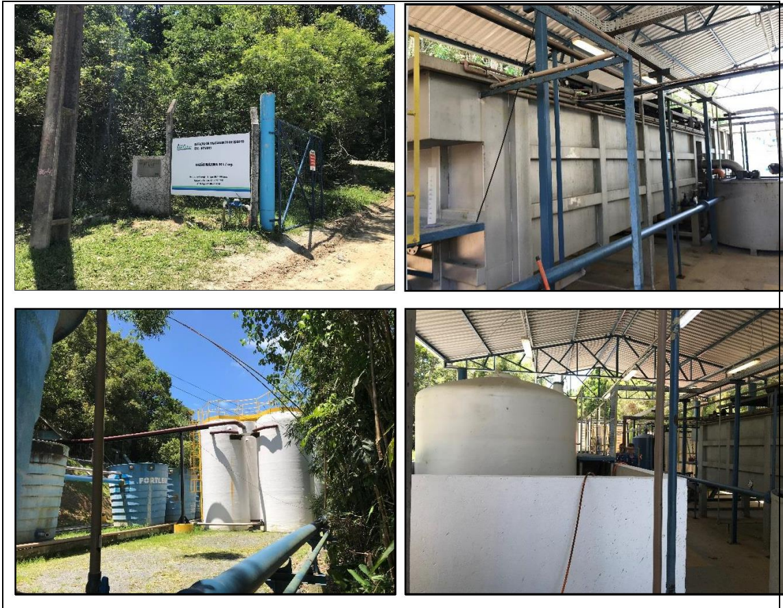
Estação de tratamento de esgoto em Bombas (Alto Uruguai Engenharia e Planejamento de Cidades, 2018).
