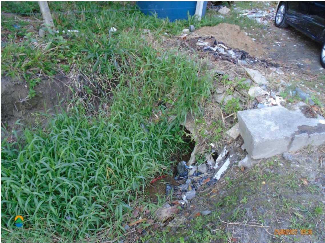
Rede de drenagem assoreada e tubulação obstruída (Eco Litoral, 2022).
