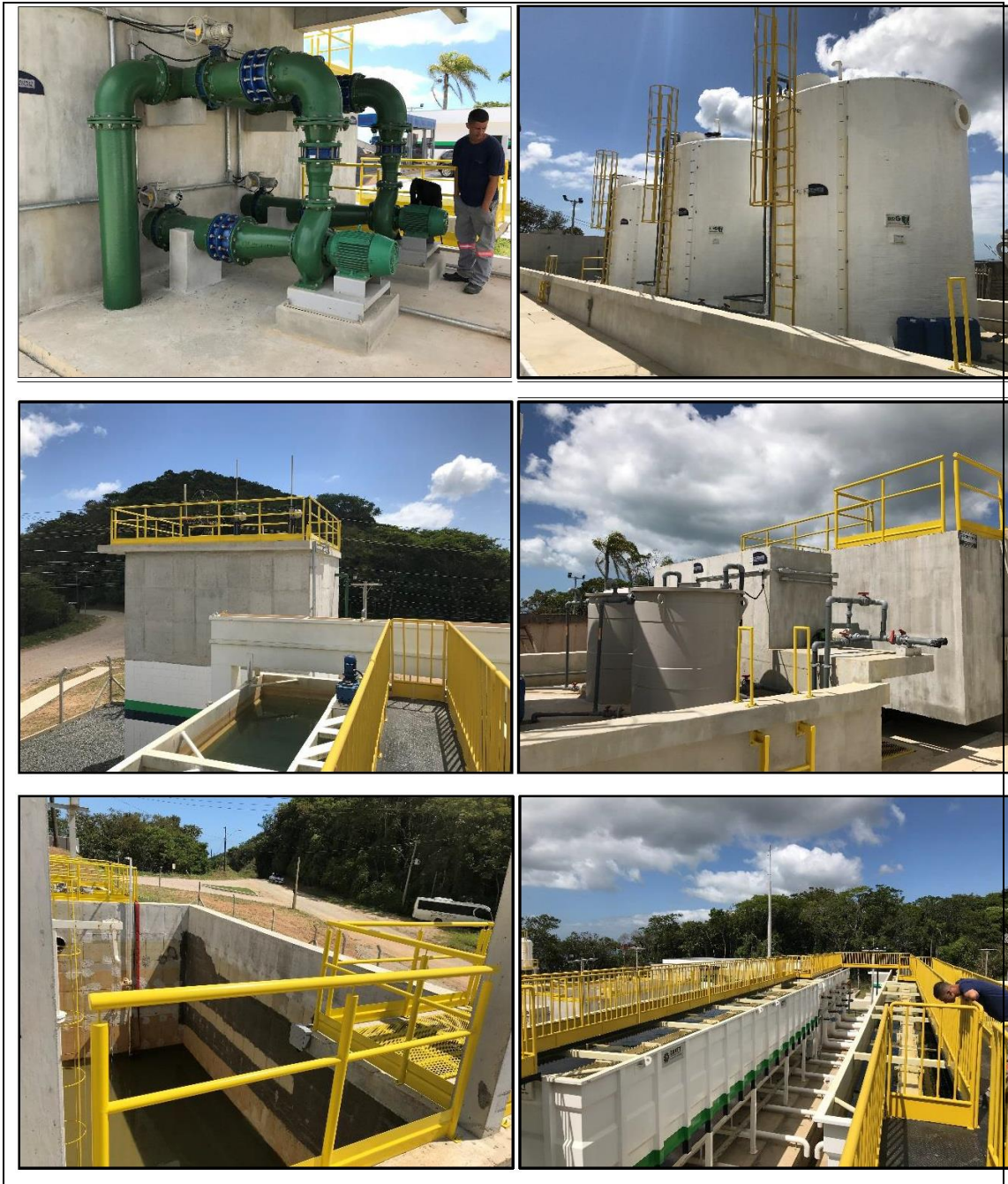
Estação de tratamento de água em Bombinhas (Alto Uruguai Engenharia e Planejamento de Cidades, 2018).
