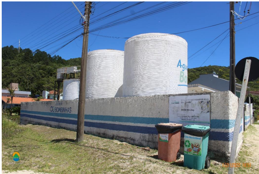
Estação de tratamento de água de Zimbros (Eco Litoral, 2022)
